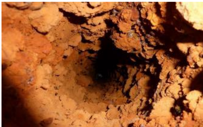
Fotografia vencedora: interior de uma tubagem de aço, Rute Fontinha, LNEC
